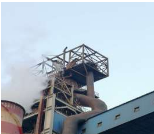
图十九 煤气均压放散阀消音器
