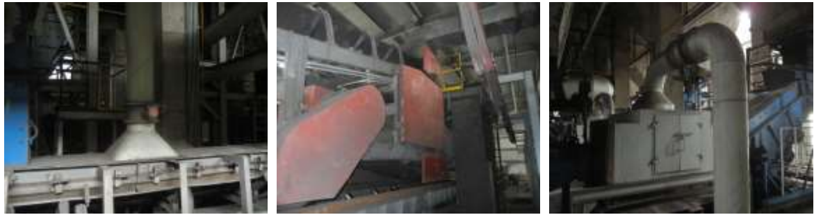
图十 皮带转运落料点、槽上移动小车卸料点、振动筛等密闭抽风收集
