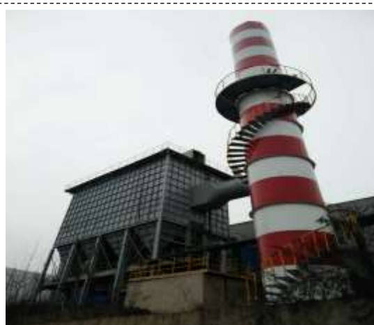
图四 地下料仓废气治理设施
