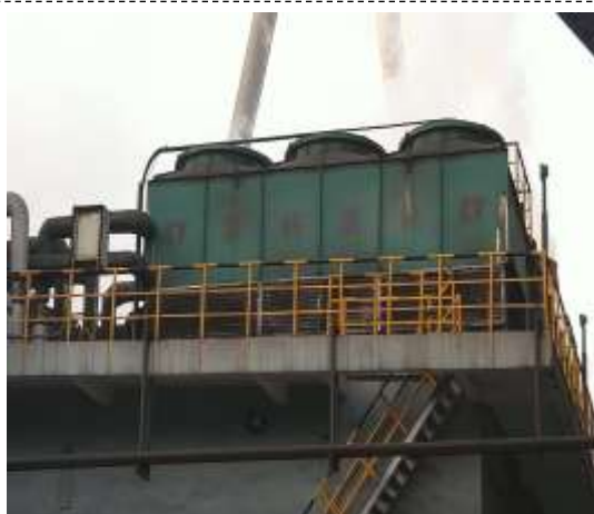
图十三 软水密闭循环冷却系统
