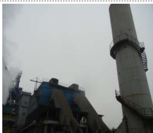
图六 高炉出铁场烟气治理设施
