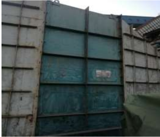
图二十一 出铁场除尘风机消音器
